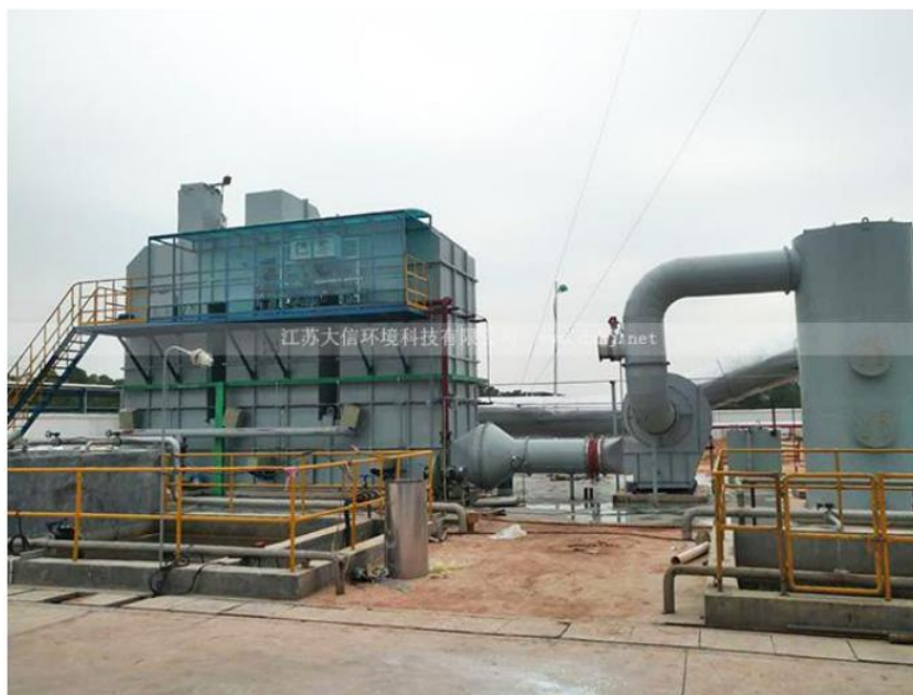
新疆独山子天利实业总公司二期废气蓄热式焚烧炉
