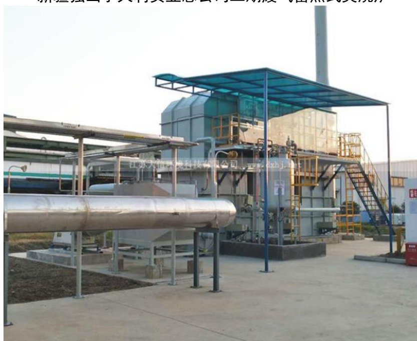
蓝星有机硅（上海）有限公司-化工废气蓄热式焚烧炉
