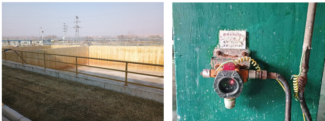
图 2.1-7 厂区事故水池及甲二车间内有毒气体浓度监测报警装置
