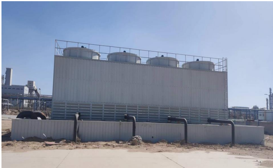
循环水系统建设现状
