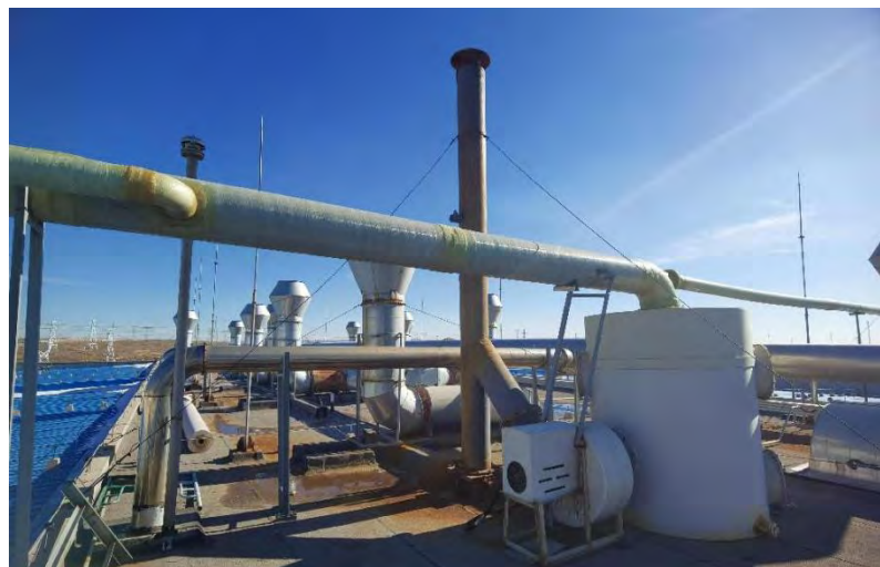
现有工程 3#生产车间排放口(DA002)以及活性炭罐
