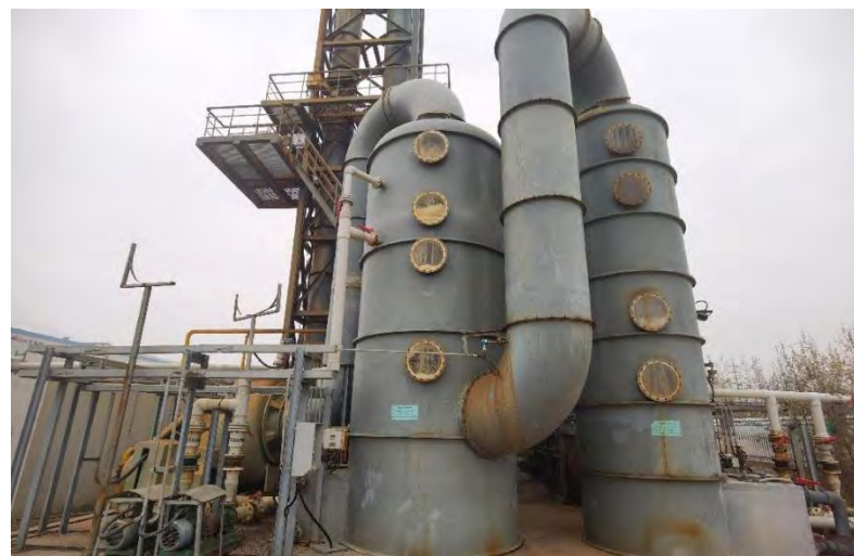
现有工程 RTO 装置配套喷淋塔
