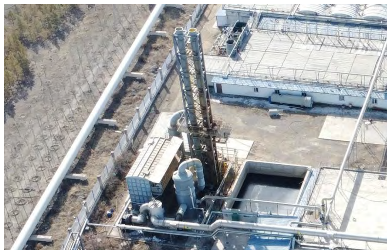
现有工程 RTO 装置排放口(DA001)以及污水处理站排放口(DA003)
