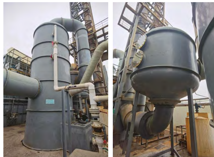
污水处理站生化废气喷淋塔及活性炭箱
