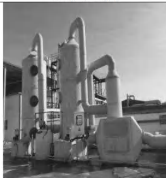
废水处理站废气处理设施
