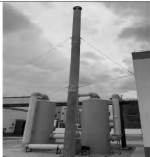
仓库废气处理设施
