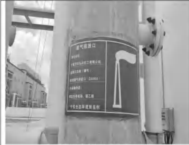
库房废气排放口 (DA003)
