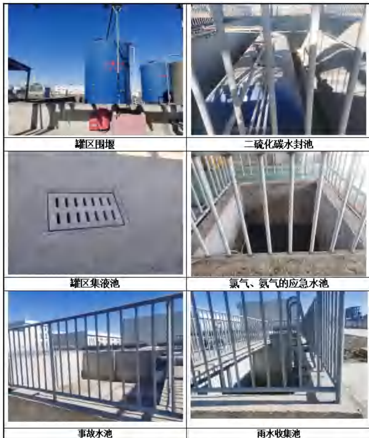
图 2.1.5-5 环境风险防范措施建设情况图
