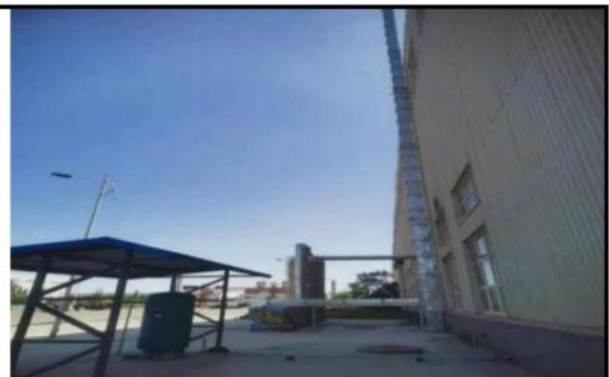
排气筒（危废桶破碎）
