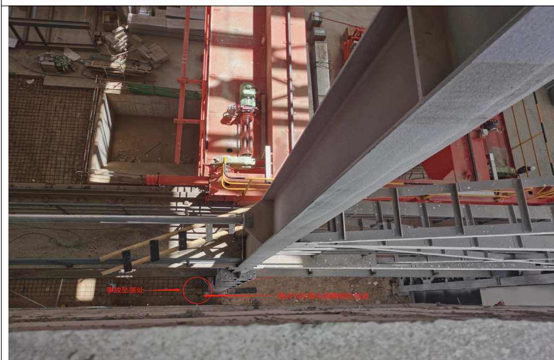
事故坠落处俯视图
