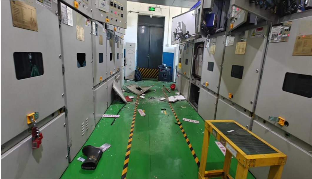
图 2 事故现场情况
